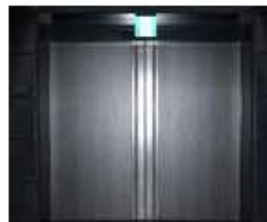
避難口誘導灯
